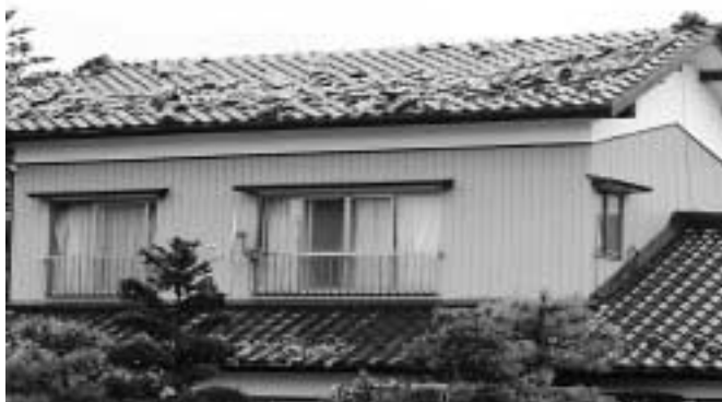
被害状況(平成17年8月29日現在)
