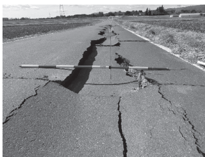
【福島県沖地震被害】
