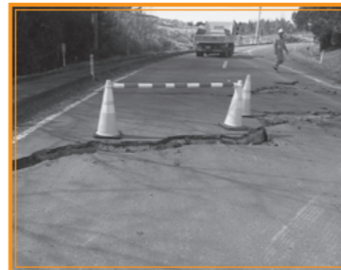
亀裂の入った町道
