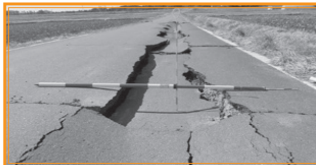
沈下した下水道
