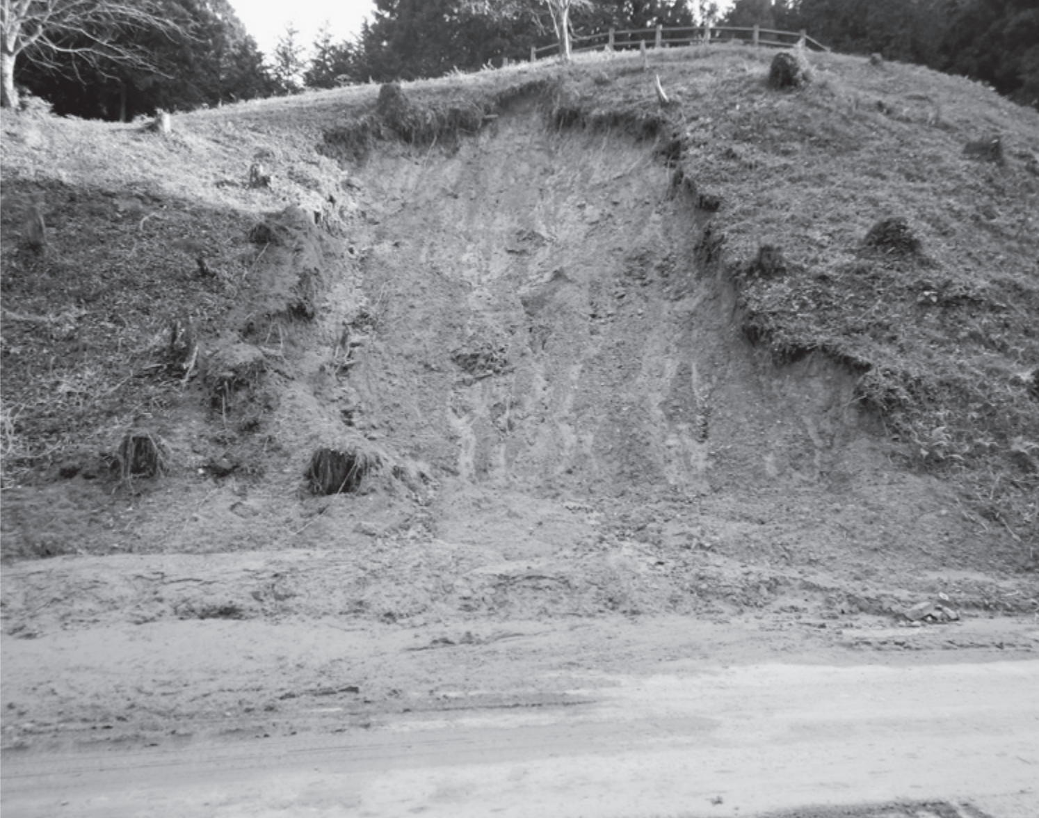
▲沢口ふれあい広場の法面崩落
