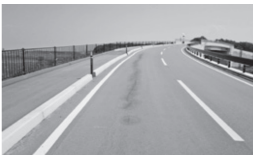
▲大富希望の橋の道路の窪み
