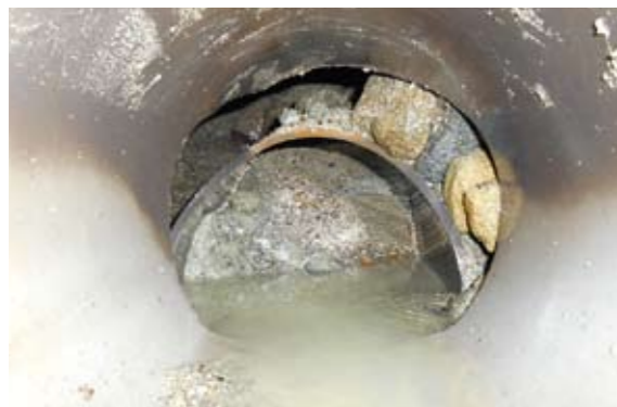
写真 5-38 損壊した下水道管内部 損壊箇所から土砂が流入し、詰まった状態
