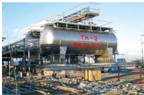
写真 5-32 震災に耐えた液化アンモニア貯槽を再使用
